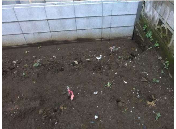
調査-12 測点4移動状況（法面）
