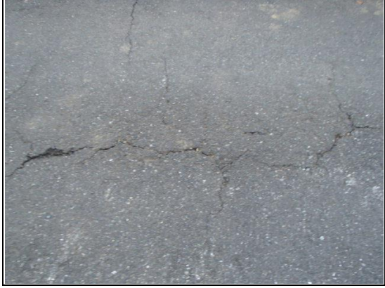
亀裂状況(前面道路)
