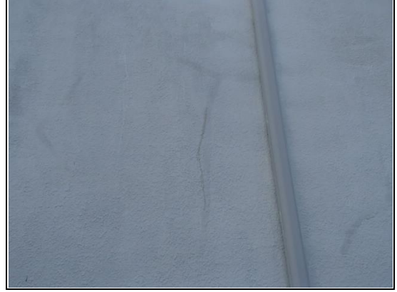
亀裂状況(東側隣家)
